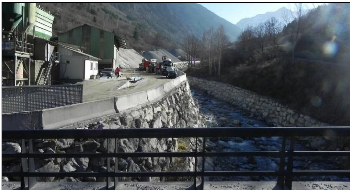
Imatge 16. El riu Valarties, en sentit N-S, amb l'escullera de protecció que es va construir fa alguns anys. S'observa que la diferència aproximada de cota entre la llera i l'àmbit és de 5-6 m.
